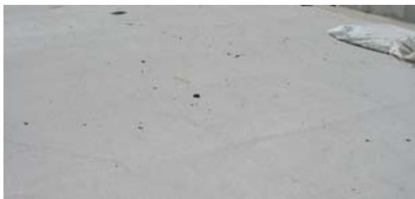
Figure 2 : Fissures de retrait
