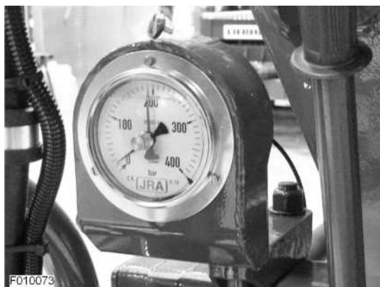
Afb. 74: Drukmanometer in de buurt van het bedieningsgedeelte
